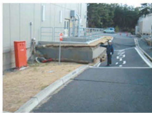
●J-PARCの敷地内では、地面が陥没したり、地下の配管が切断するなど、大きな被害がありました。
