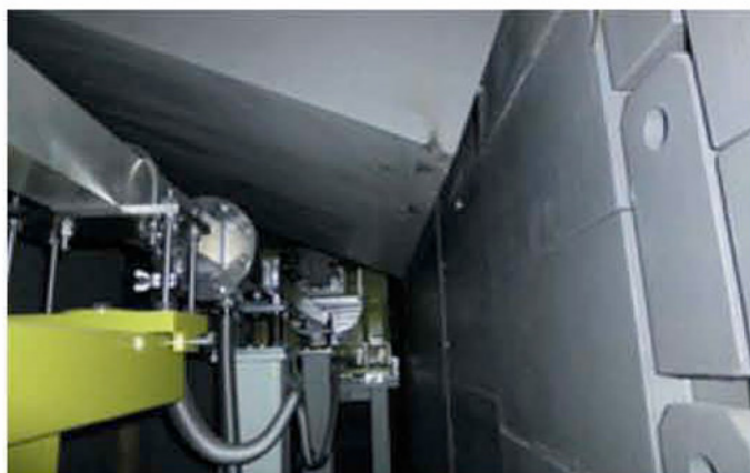
●ひとつの重さが約5トンもある遮蔽体(写真上部)が地震によってずれました。幸いにもその下にある実験装置に被害はありませんでした。
